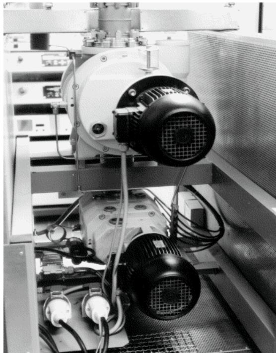
Abb. 2.6.2: Ansicht des Vorpumpenstandes und seiner Einzelkomponenten im geöffneten Schallschutzgehäuse
