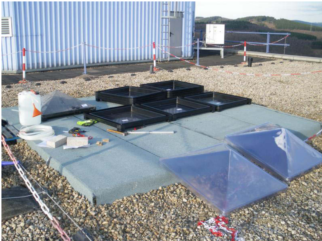
Abbildung 52: Aufbau der Sunwater-Factory am Dach der Universität Siegen (eigene Darstellung)
