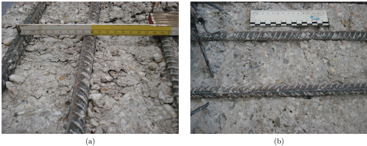
Abbildung 4.24: Prüfkörper B6 , (a) Schuppenartige Betonreste nach Versagen, (b) Freiliegende Bewehrungsstäbe ohne Verbund
